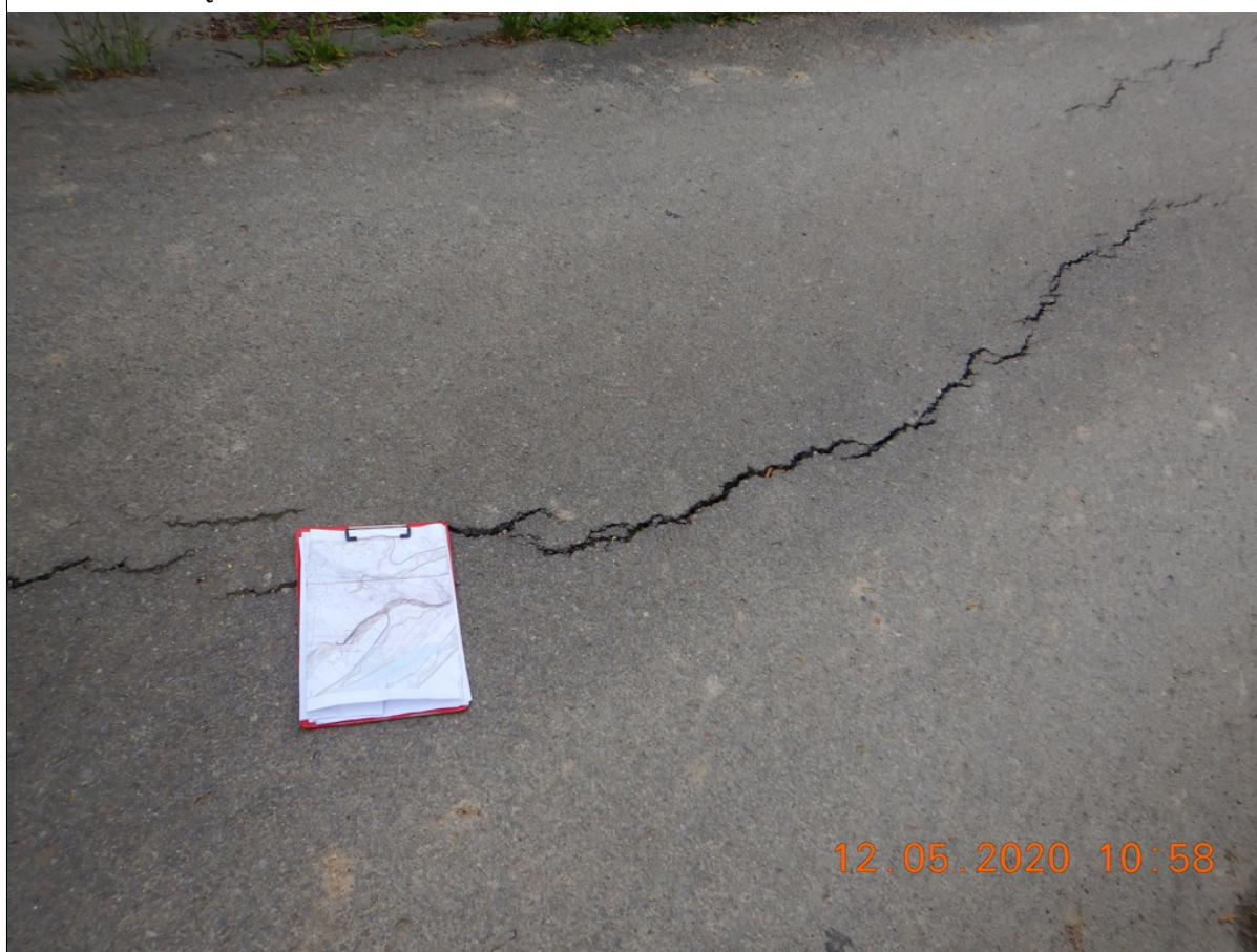
Spękania na drodze przebiegającej przez osuwisko (maj 2020)
