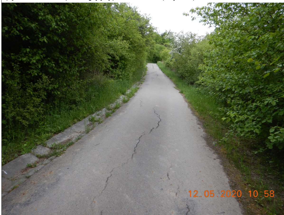
Spękania na drodze przebiegającej przez osuwisko (maj 2020)
