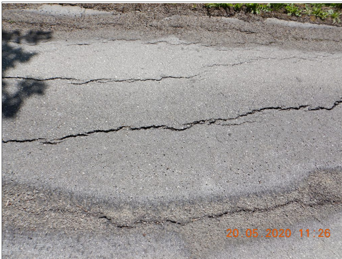
Spękania na drodze przebiegającej przez osuwisko (maj 2020)
